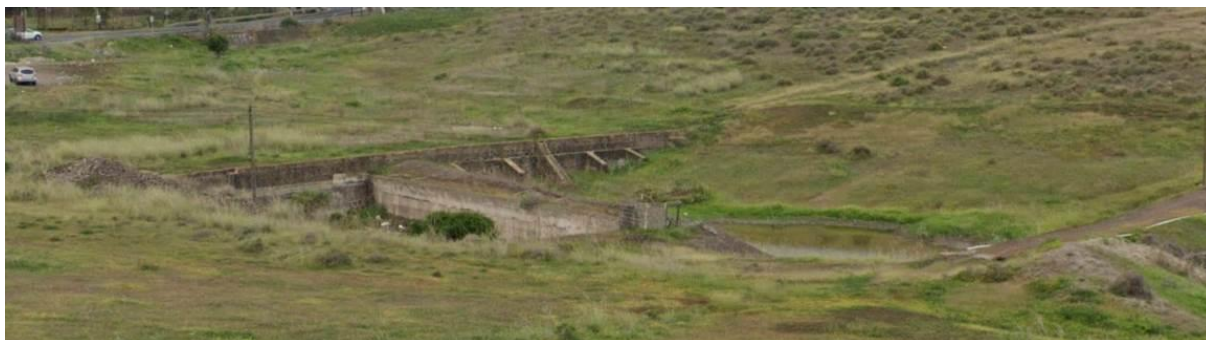
Estanque y balsa de agua en estado de abandono localizados en el sector de Finca de los Sifones
