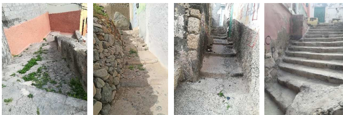
Ejemplos de peatonales en mal estado: Gregorio Gutiérrez (1) / Malta (2) / Moneda (3) / Gabarra (4)
