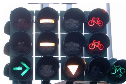
IN21 Renovación del sistema semafórico hacia un sistema central de tráfico
