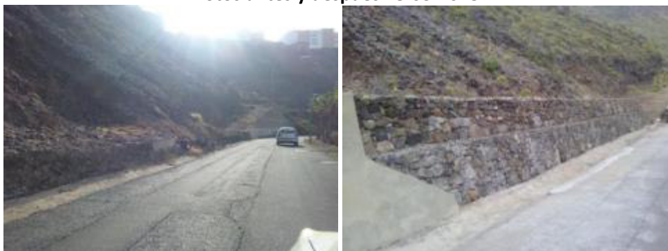
Fotos antes y después 28-03-2018:
