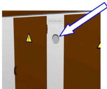
Figura 1.3: Vista exterior de entrada auxiliar BT en PFU
