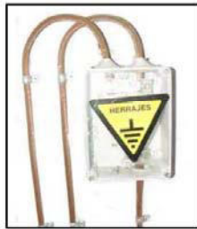
Figura 1.6: Caja de Seccionamiento de Protección
