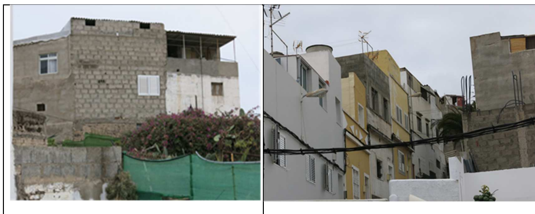
Figura 49. Descontrol de volumetrías y medianeras vistas.
