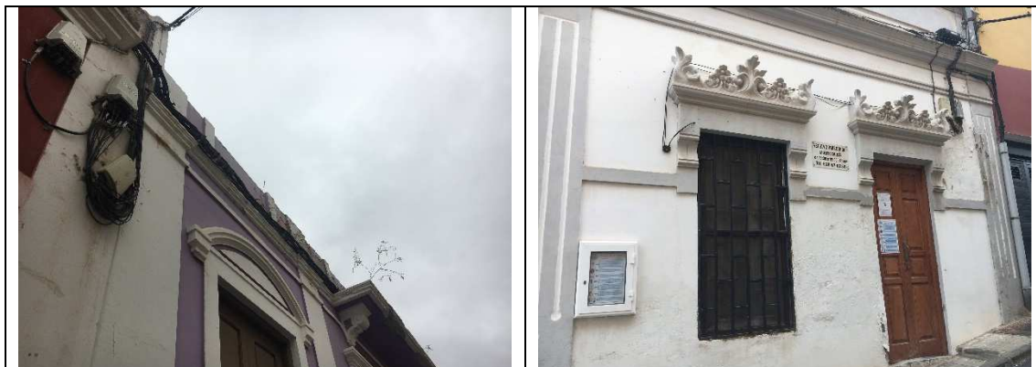
Figura 44. Impacto de cables en fachadas en edificios protegidos.
