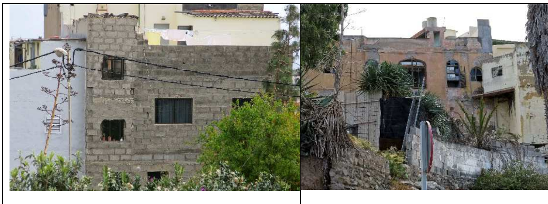
Fotográfico 17 y 18. Inadecuación de fachadas
