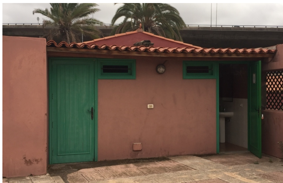
Prolongación del módulo oriental de la Casa del Mayordomo, actualmente utilizado como baño
